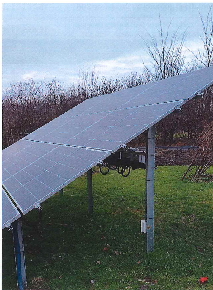
Foto 6: Instalacja fotowoltaiczna w ramach projektu „OZE w Gminie Jeziorzany”, źródło własne.
